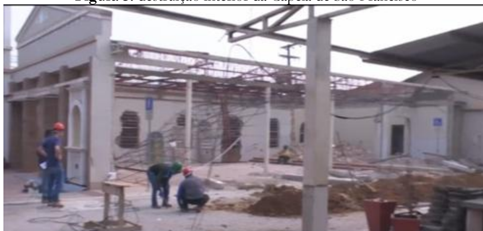
Figura 5: destruição interior da Capela de São Francisco
